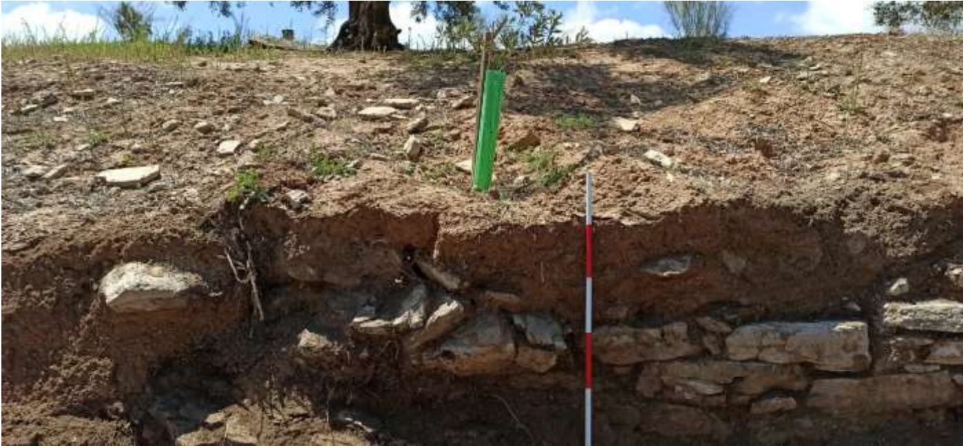
Fotografía 12. Zona del muro Norte más dañada por los trabajos agrícolas.
